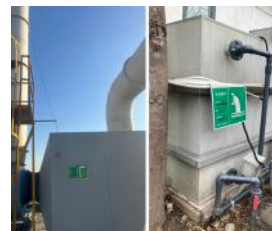
集团下属检验公司实验室 废气和废水处理装置
